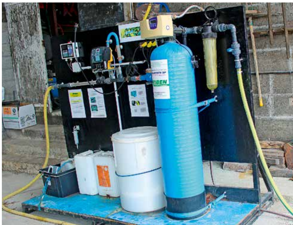
La station de traitement de l'eau Aquatiben 3P.
